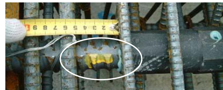
写真7 鉄筋の挿入不足 (機械式継手)
